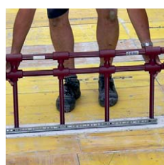
Einfadeln des Temperierungsmoduls
